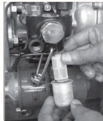
Чистка стакана подкачивающего топливного насоса
